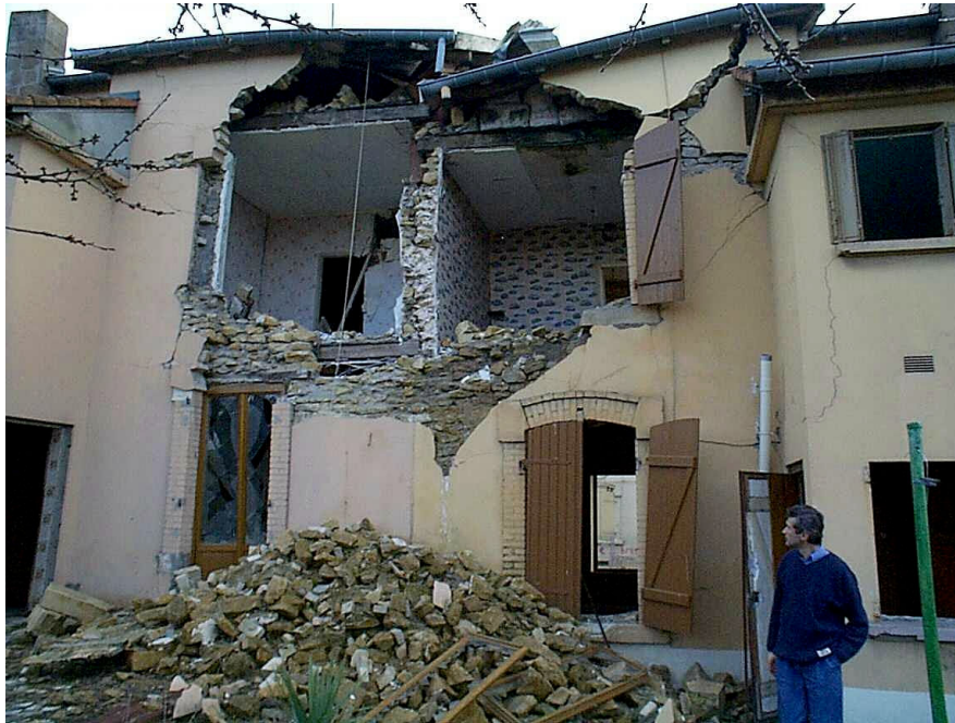
Photo 5 : Conséquences sur le bâti des affaissements d'Auboué (Bassin ferrifère lorrain)
