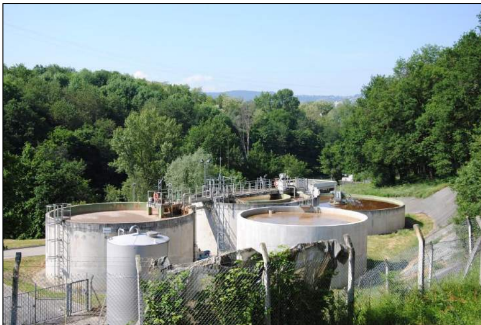
Figure 6 : Vue sur la station d'épuration interne (Source : SUEZ RV Borde Matin)
