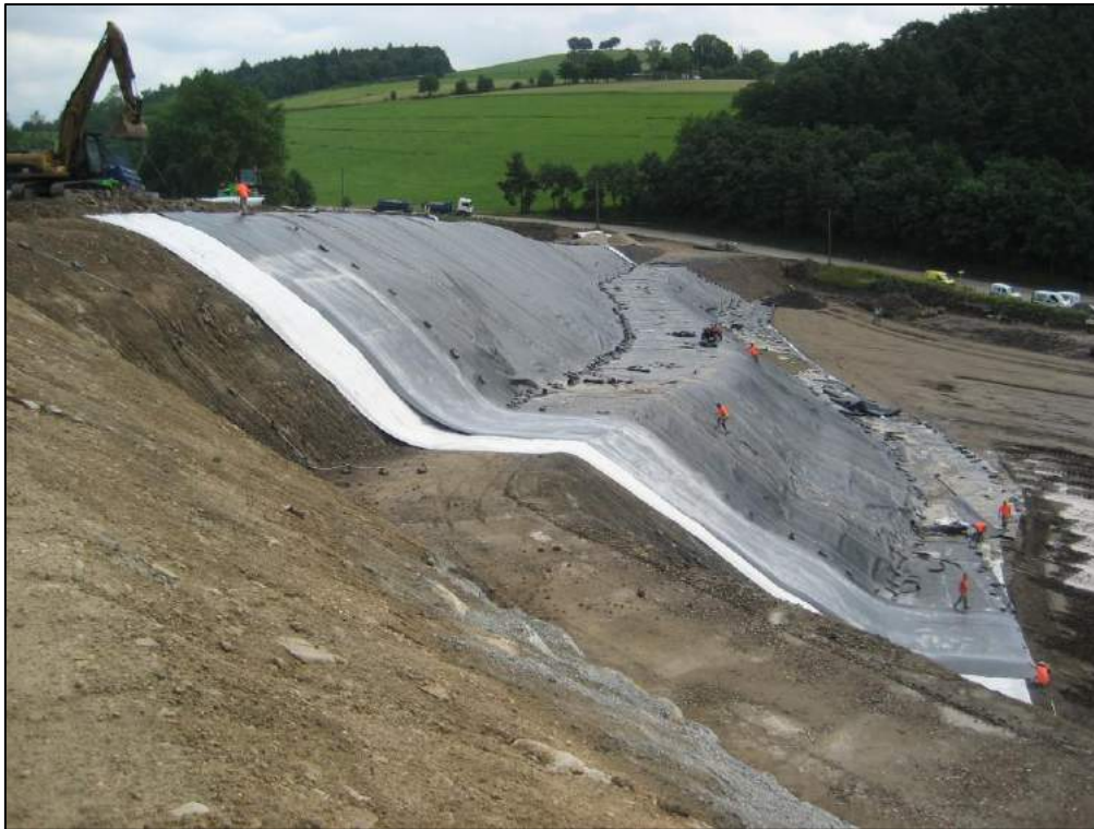
Figure 4 : Vue sur un casier en cours de création (pose de la barrière active) (Source : SUEZ RV Borde Matin)
