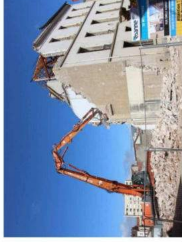
Figure 6 : Vue des travaux de démolition de l'immeuble du 26 rue Émile Noirot en mars 2021 (Photo Progrès /Max CHAPUIS)
